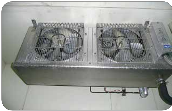
冷蔵庫内正常な冷却器外観
