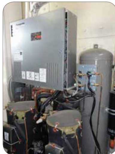
機械室内部にある冷凍機
