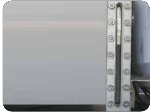
受液器液面計の液面位置
