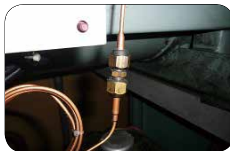
圧力検知配管に油がにじんでいる例
