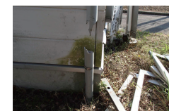
③縦樋の破損
