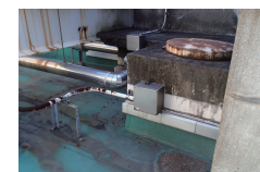
②配管に発錆
