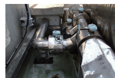
①給水管のへこみ
