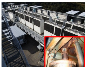
空調の停止 (ウエスト2号館)
